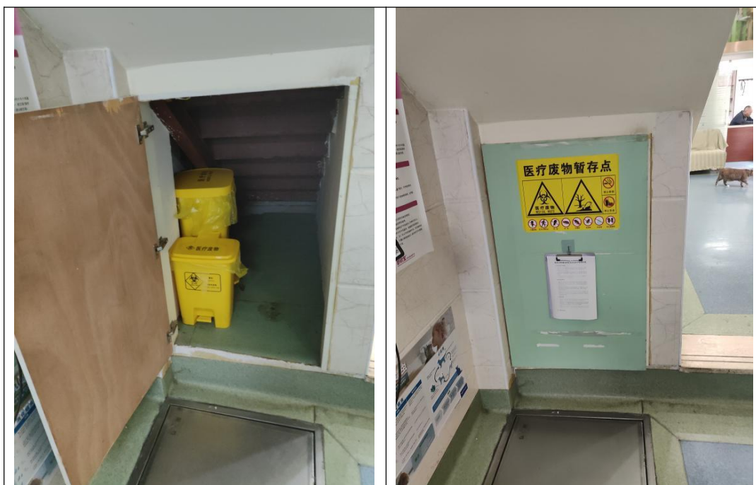
图 4-3 现有危废间治理设施图
